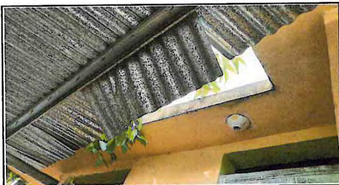
Foto 9: Lámina considerablemente dañada en el área de los baños. Provoca inundaciones en épocas de lluvia.
