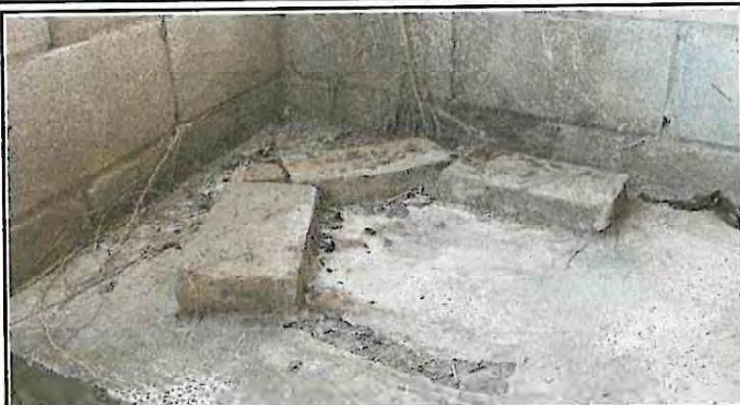
Foto 1: Hornilla del polletón deteriorada y maltratada. Área de la cocina escolar.
