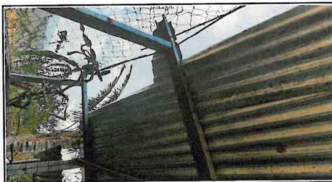
Foto 10: Láminas considerablemente dañadas en área de la cocina escolar. Impide la preparación de los alimentos cuando llueve.
