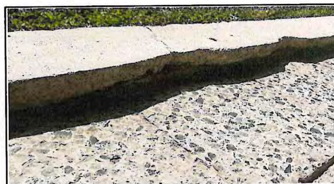
Foto 4: Piso del corredor frente a los salones con hundimiento y desnivelación riesgosos.
