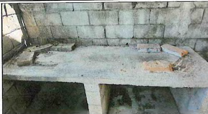
Foto 2: Polletón para cocinar con hornillas considerablemente deterioradas.
