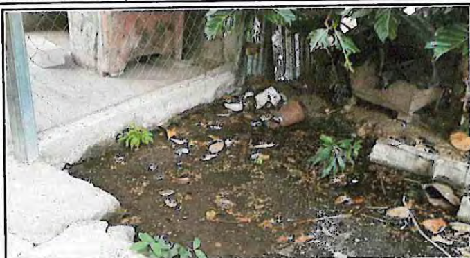
Foto 7: Fosas sépticas obstruidas por falta de limpieza. Hay brote de aguas negras en el patio frente a la cocina escolar y baños.
