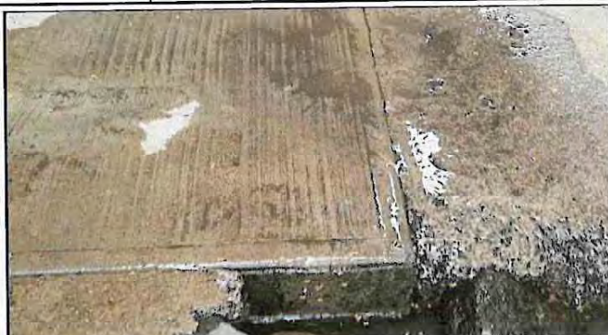
Foto 8: Fosas sépticas obstruidas hacen brotar aguas negras en la plancha de cemento del área de los baños y cocina escolar.
