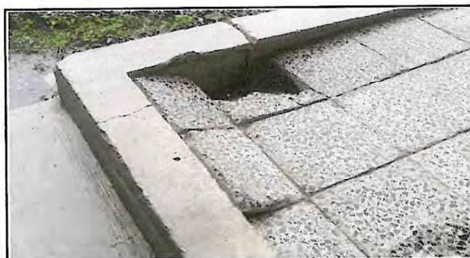
Foto 3: Piso de granito considerablemente dañado en el corredor frente a los salones.
